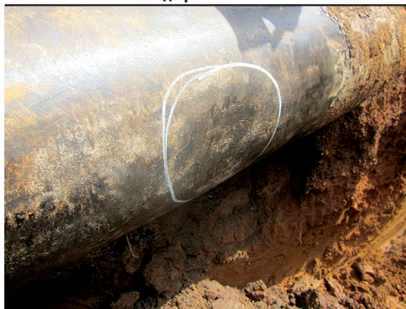
Рис. 6. Выявленный дефект «вмятина»
